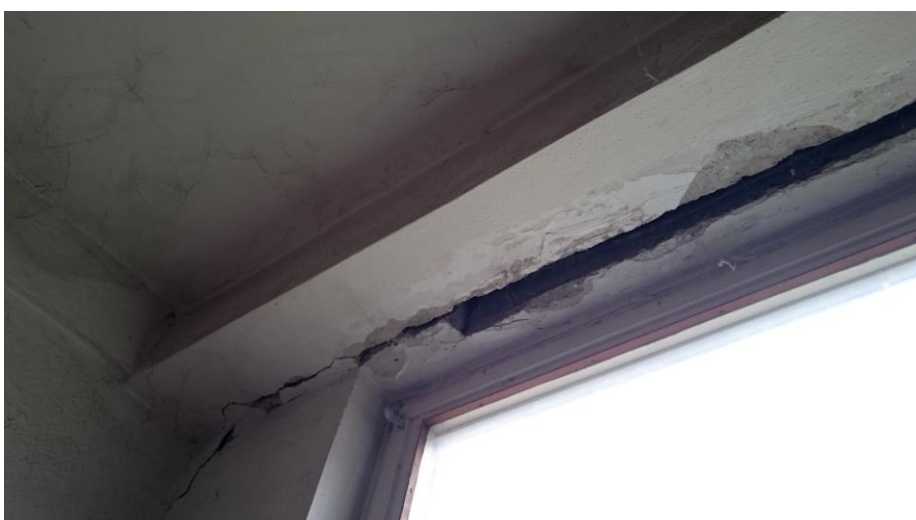
obr. 16 Vypadlá část vycpávky (2016)
