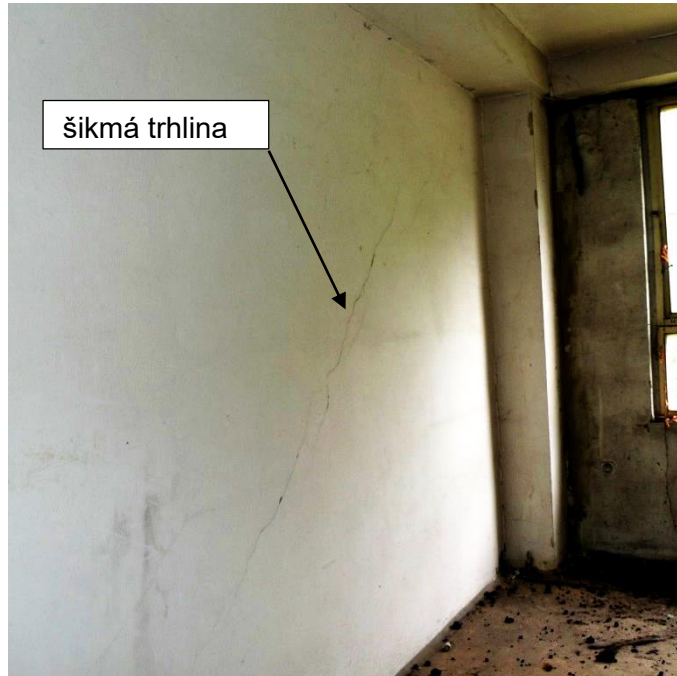
obr. 10 Trhliná v příčce u jižní fasády
