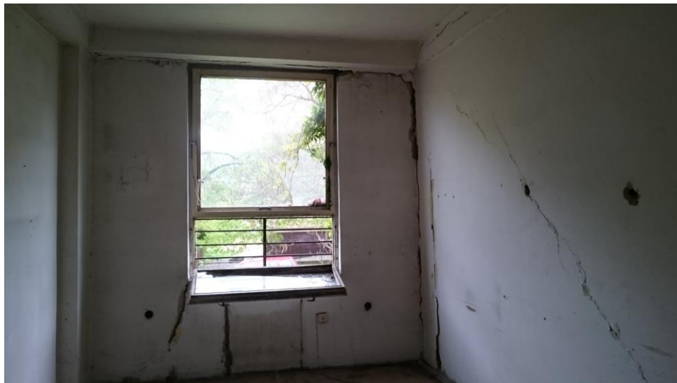
obr. 11 Shodná trhliná na opačné straně příčky (2016)
