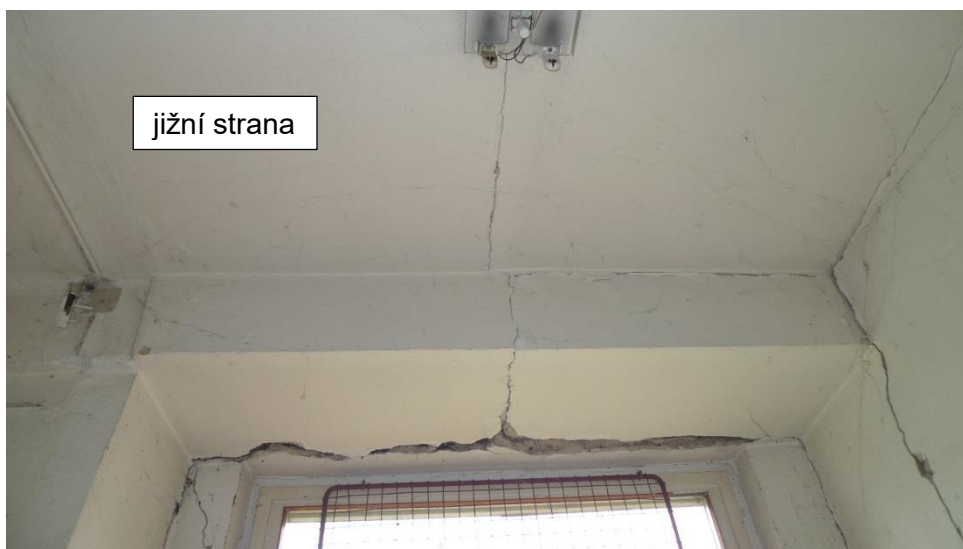
obr. 8 Nadpraží okna z obr. 6, naklonění západní fasády a oddálení jižní části hlavní nosné konstrukce od severní
