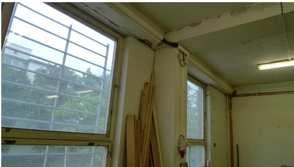
obr. 14 Trhliny u stropu 1.NP podsklepené části
