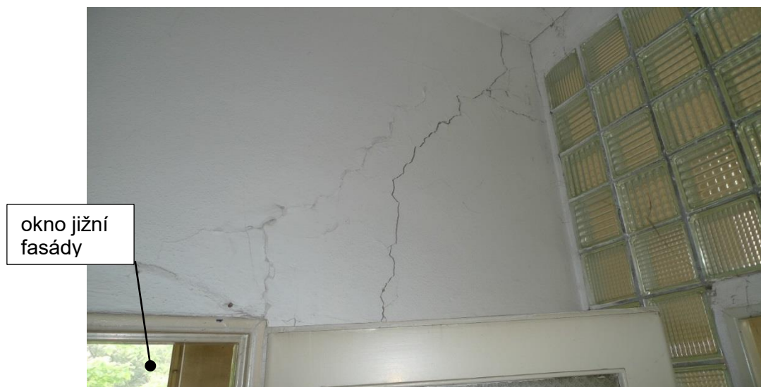
obr. 12 Trhlina v podélné příčce chodby, u vstupu do místnosti při západním štítu
