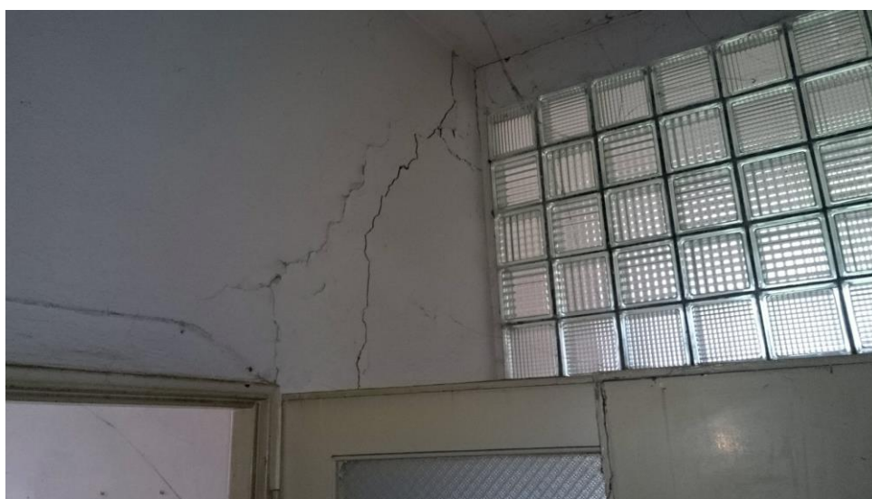
obr. 13 Porovnání trhliny z obr. 12 (2016)
