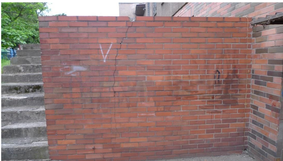
obr. 18 Porucha na venkovní zídce u podsklepené jižní fasády
