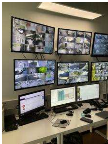
Obrázek 13 - CCTV systém ve velíně
