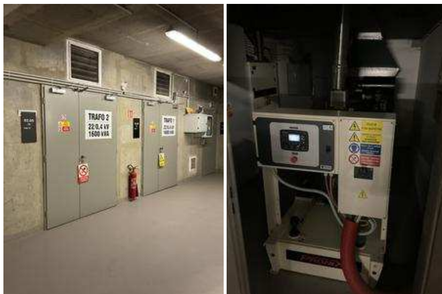
Obrázek 15 - TS v objektu MFC + záložní DA
